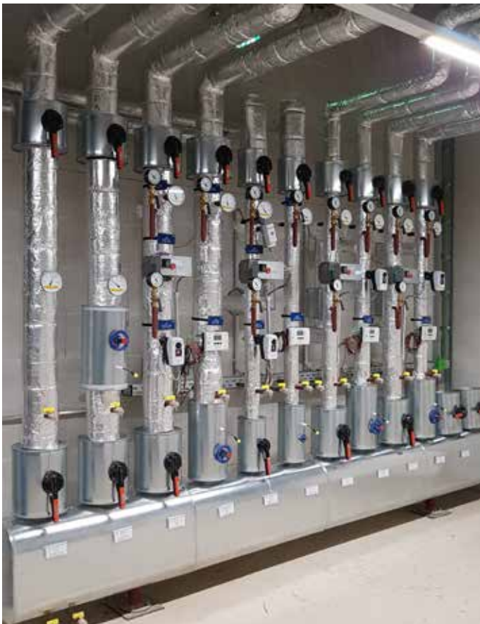
Bild unten: Heizungsverteilung
